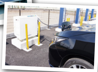
電気自動車（EV）は災害時には非常用電源としても活用できる
