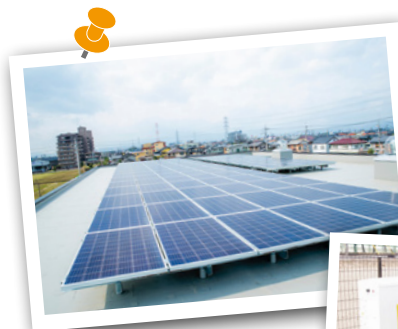
屋上に設置した太陽光パネルにより再生可能エネルギーを創出
