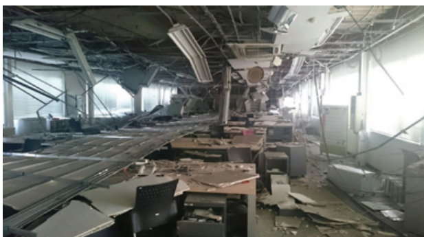
本震後の熊本支社3階。居室の天井が全面落下し、キャビネットなどが散乱している
