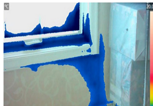
温度レンジやカラーパレットを変更することで、雨漏りしている箇所をより鮮明に表示できる。
